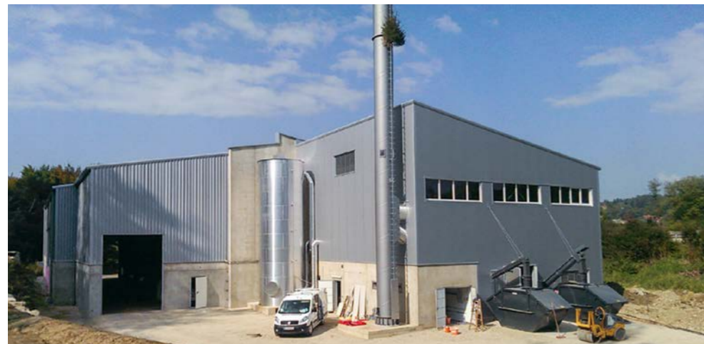
Die alte Eishalle wurde zum Biomasse-Heizwerk umgebaut, das ins lokale Fernwärmenetz einspeist. Der Anteil erneuerbarer Energie muss weiter ausgebaut werden. (Foto: Leo Riebenbauer)
